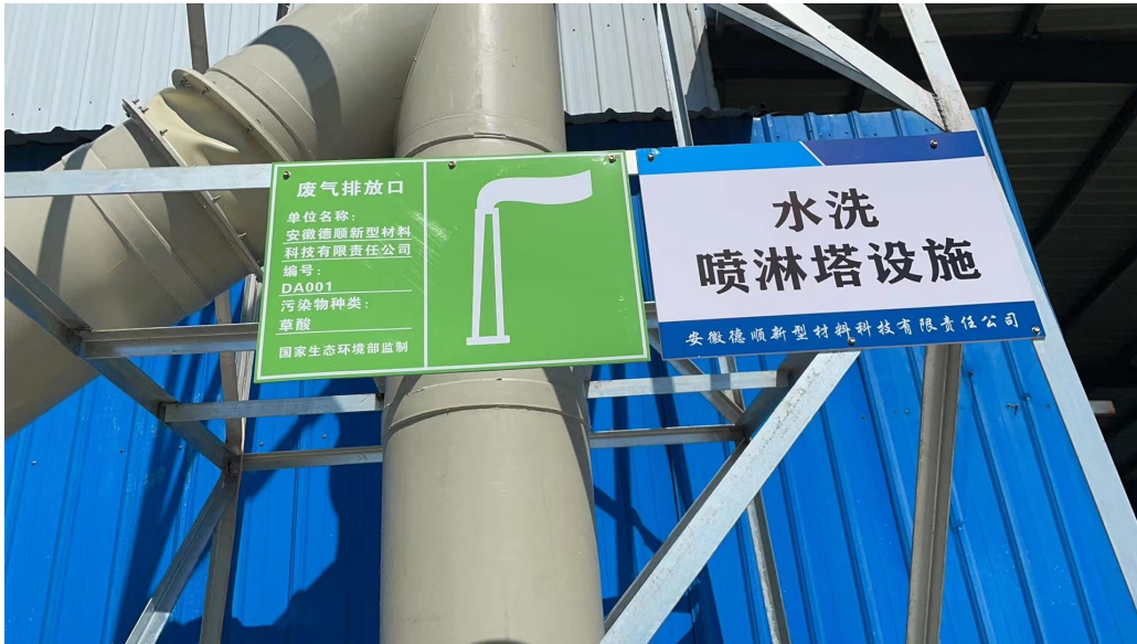
锅炉烟气：低氮燃烧器+8m 高排气筒（DA003）；
